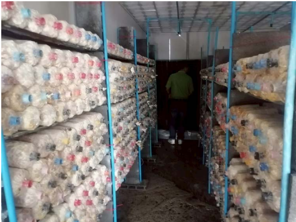
ภาพที่ ๓ แสดงถึงโรงเรือนเปิดดอกเห็ดที่ติดตั้งระบบ Evap เพื่อลดอุณหภูมิ
